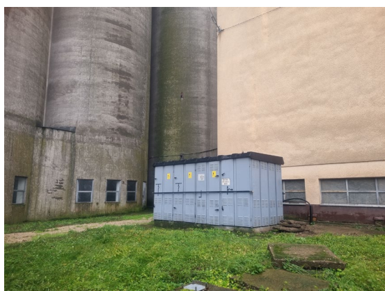
Slika br. 24. Trafostanica
