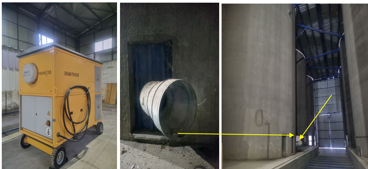
Slika br.25, 26 i 27. Uređaj Frigo, priključak uređaja na silos
