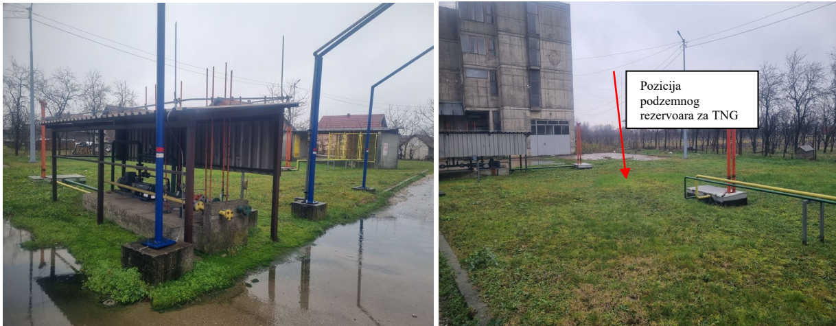
Slika br. 15 i 16. Izgled pretakališta TNG, isparivačka stanica i pozicija podzemnog rezervoara za TNG
